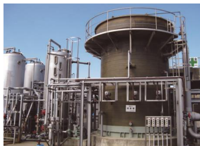
【イオン交換樹脂法設備】
