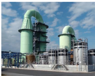
【ブローイングアウト法設備】
